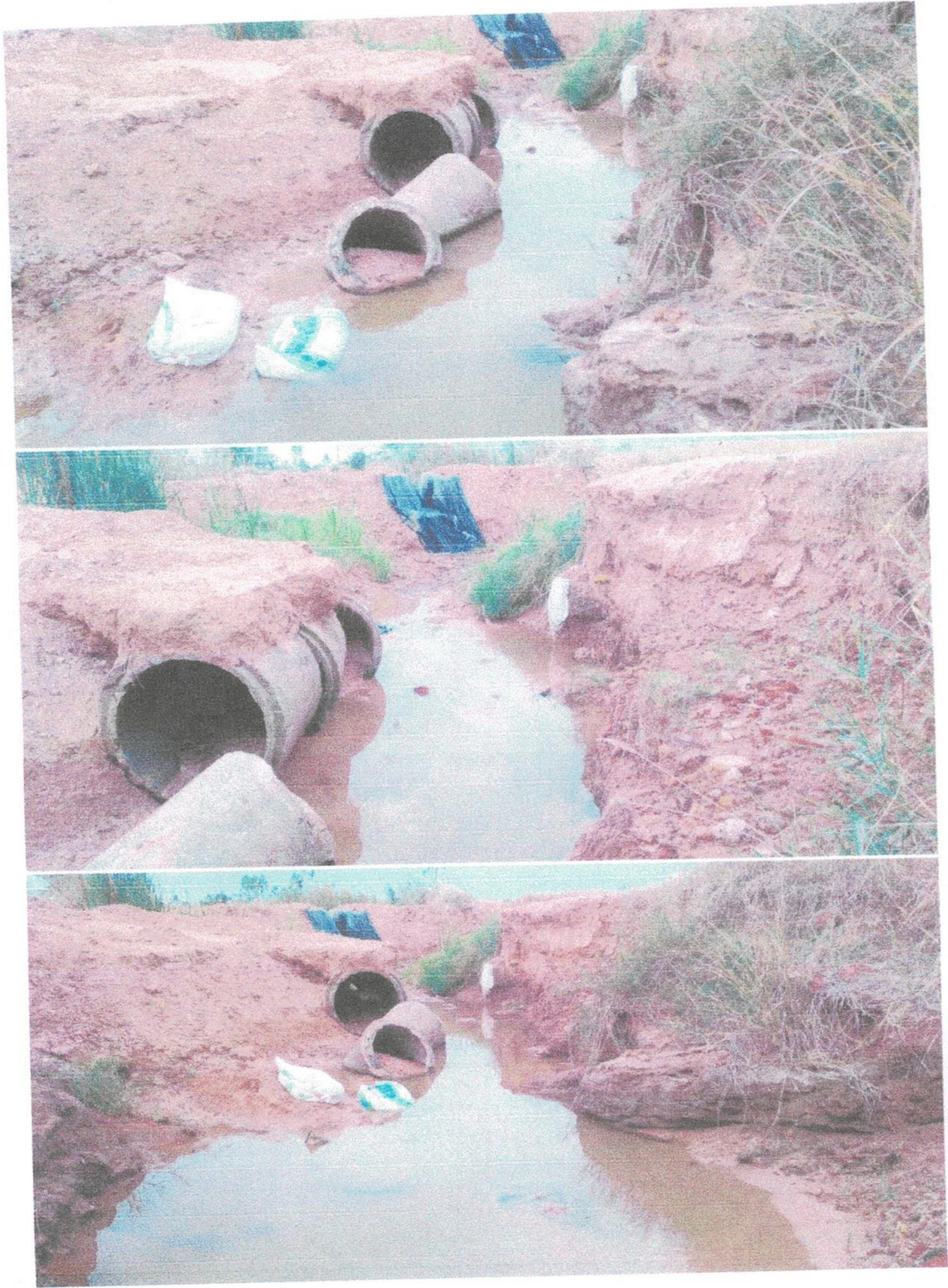
รูปถ่ายกันดูคูหา และทางน้ำคลองสระแกที่เสียหายจากน้ำกัดเซาะจากอุทกภัย เมื่อเดือนกันยายน ปี 2565 บ้านตะคร้อ หมู่ 7 ต.สำโรง อ.โนนไทย จ.นครราชสีมา ต้องการซ่อมแซมเร่งด่วนเพื่อเก็บน้ำไว้อุปโภค-บริโภคในฤดูแล้ง 2566
